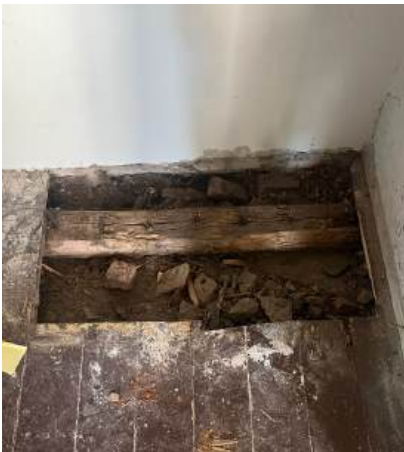
Abb. 18: Holzbalken mit Feuchtigkeit von über 20%
