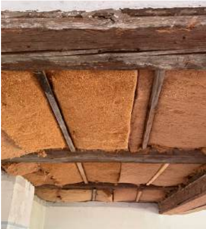
Abb. 12: Zustand Decke vor den Eingriffen
