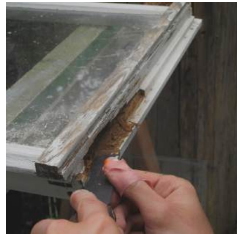
Abb. 6: Schaden durch Staunässe
