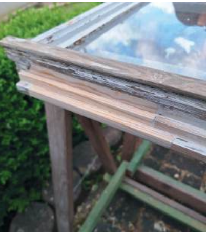
Abb. 31: Passgenaue Ergänzung eines beschädigten Fensterrahmenteils
