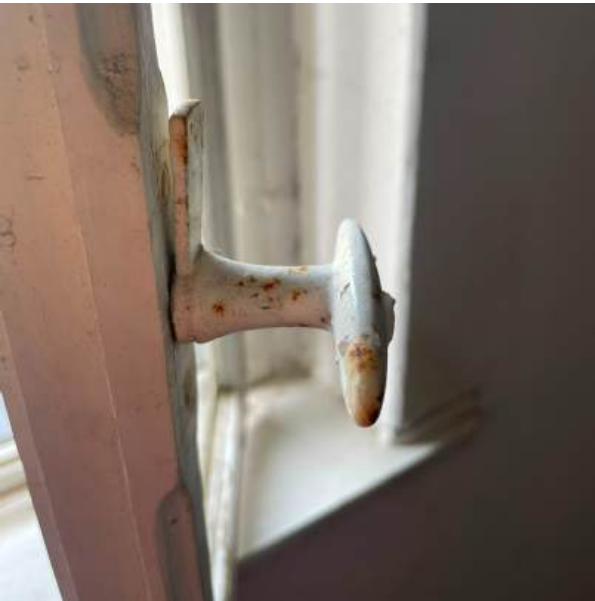
Abb. 4: Korrosion am Fenstergriff
