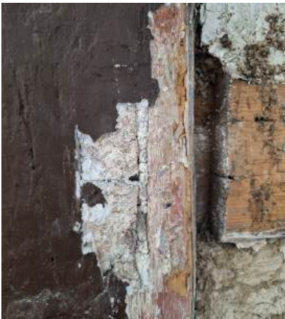
Abb. 1: Schädlicher Lack auf einem Holzbalken
