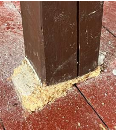
Abb. 22: Fußbodenuntersuchung: Feststellung einer nachträglich hinzugefügten Stütze
