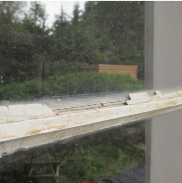
Abb. 3: Kittausbruch am Fensterflügel
